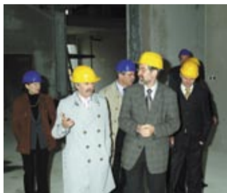
Minister dr. Jure Zupan si je ob obisku ogledal prvega med Hidriinimi razvojno-tehnološkimi centri – godoviški inštitut za klimatizacijo, gretje in hlajenje, ki ga je korporacija začela graditi lani.
